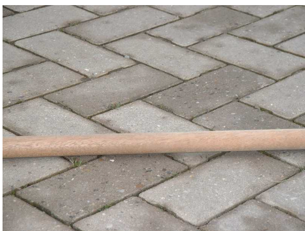
Figuur 7 Geen spoorvorming Aquaflow rijweg
