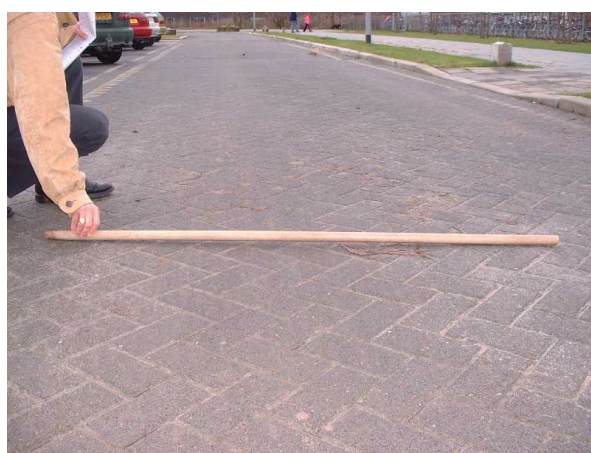
Figuur 8 Lichte spoorvorming rijweg Ecodrain 40 cm fundering
