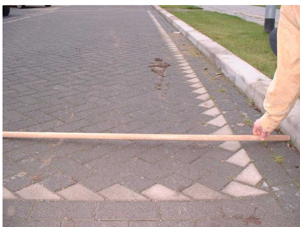
Figuur 9 Spoorvorming rijweg Ecodrain 25 cm fundering
